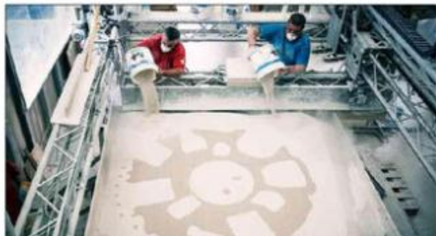
Suivant les dessins réalisés par les scientifiques, le projet est réalisé en couches successives, alimenté manuellement par des seaux de sable. (Photo DR)
