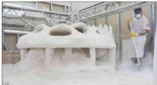
Une fois construit, le récif est vidé, à la main, du sable restant pour former les cavités où viendra se nicher la biodiversité marine. (Photo DR)
